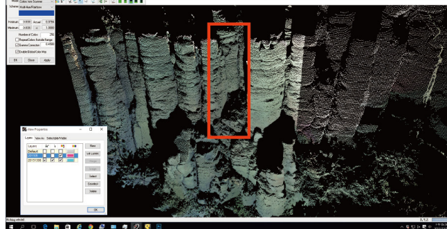
圖1 桶盤嶼2015年颱風季節玄武岩柱崩落位置與體積測量
